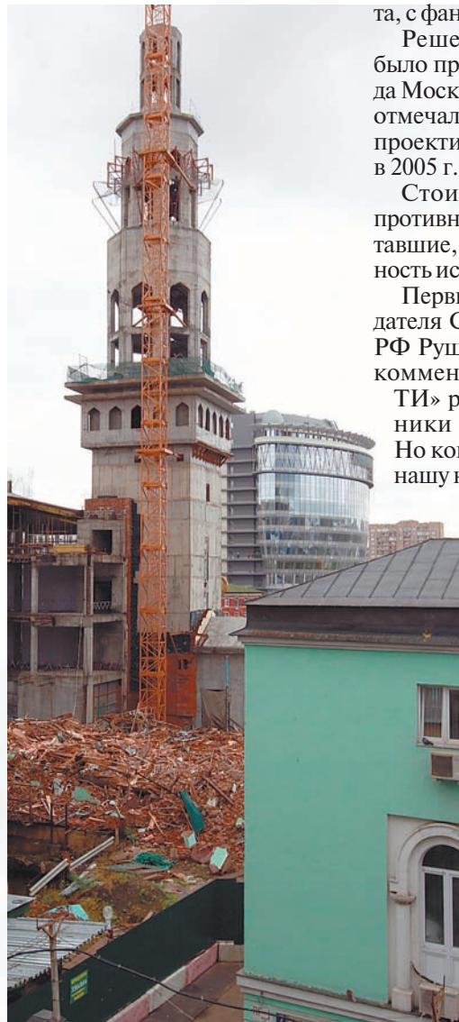
Реконструкция началась в 2005 году, к этому моменту состояние исторического здания мечети было аварийным. Фото РИА Новости
