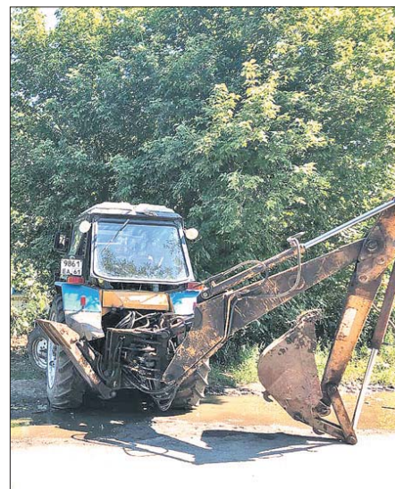
Трактор приехал, чтобы починить порыв, но задел провод электропередач.
