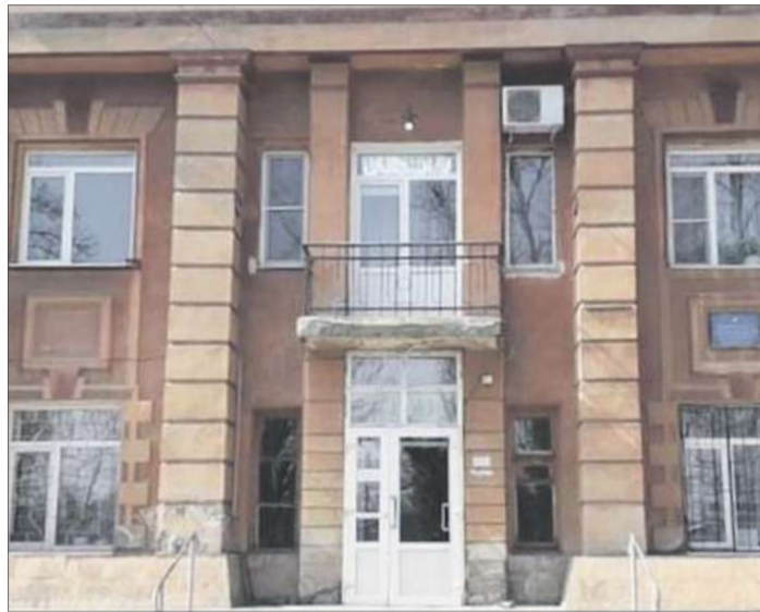
Появилась надежда, что разрушающееся здание больницы поселка Артем отремонтирует.
