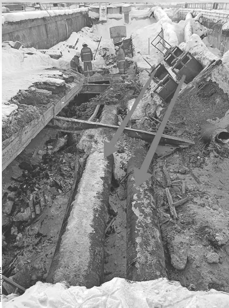
Место аварии. Стрелками показаны точки разрыва в трубе.
