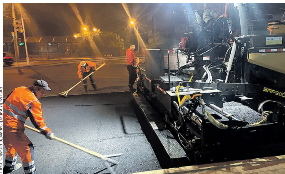
В прошлом году был отремонтирован участок улицы Байкальской. В этом работы на ней продолжатся.
