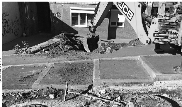
Как сообщает городминистрация, дефект выявили на бесхозных сетях в районе дома №31 по улице Сурикова.
