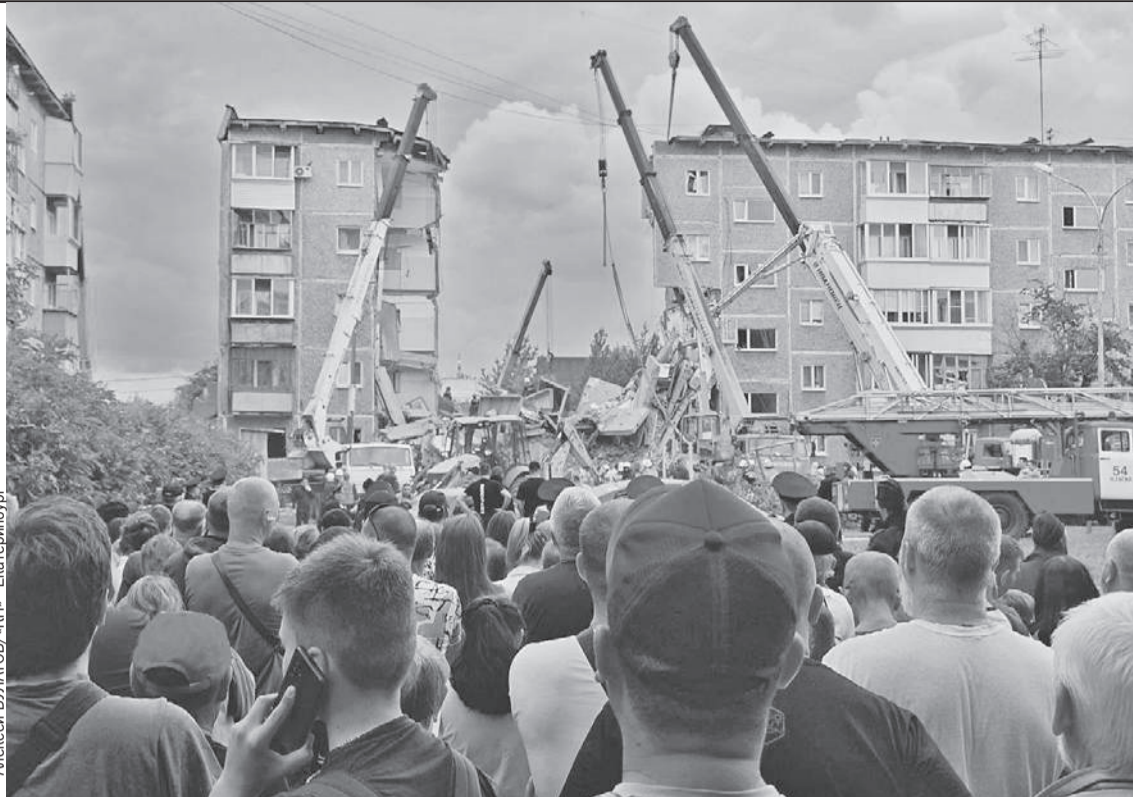
Люди буквально смотрят сквозь дом на соседнюю улицу - от двух подъездов ничего не осталось.
