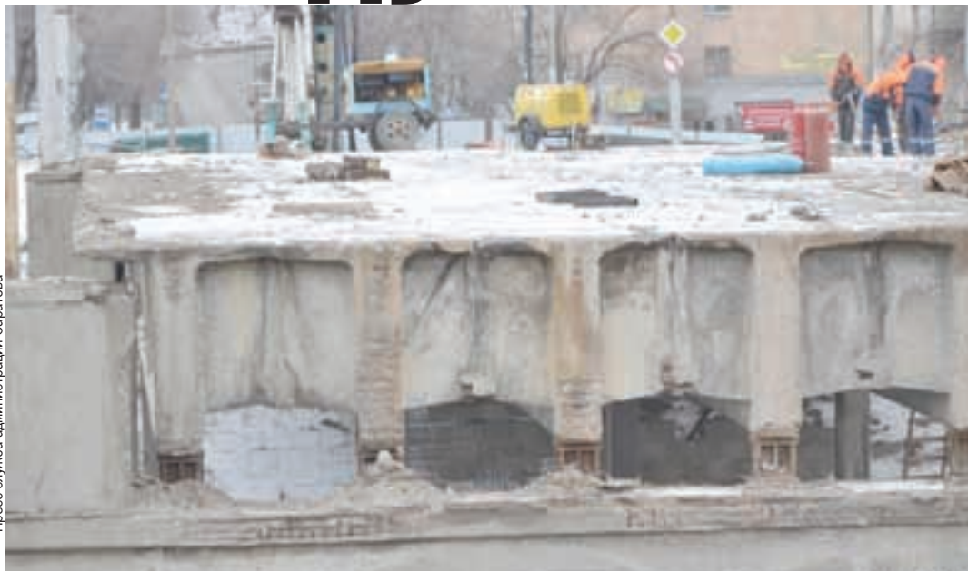
Примерно за 50 лет эксплуатации состояние старого моста стало неудовлетворительным.
