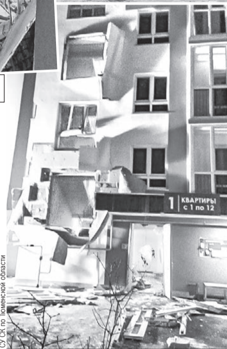
Пострадали окна и обшивка дома.
