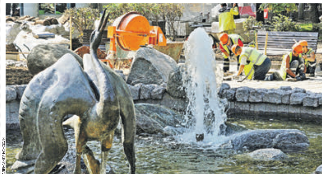
18 августа 10:30 Специалисты Гормоста обновляют мощение на площади вокруг фонтана и маскируют швы на плитке, под которой прошли кабели для декоративной подсветки
