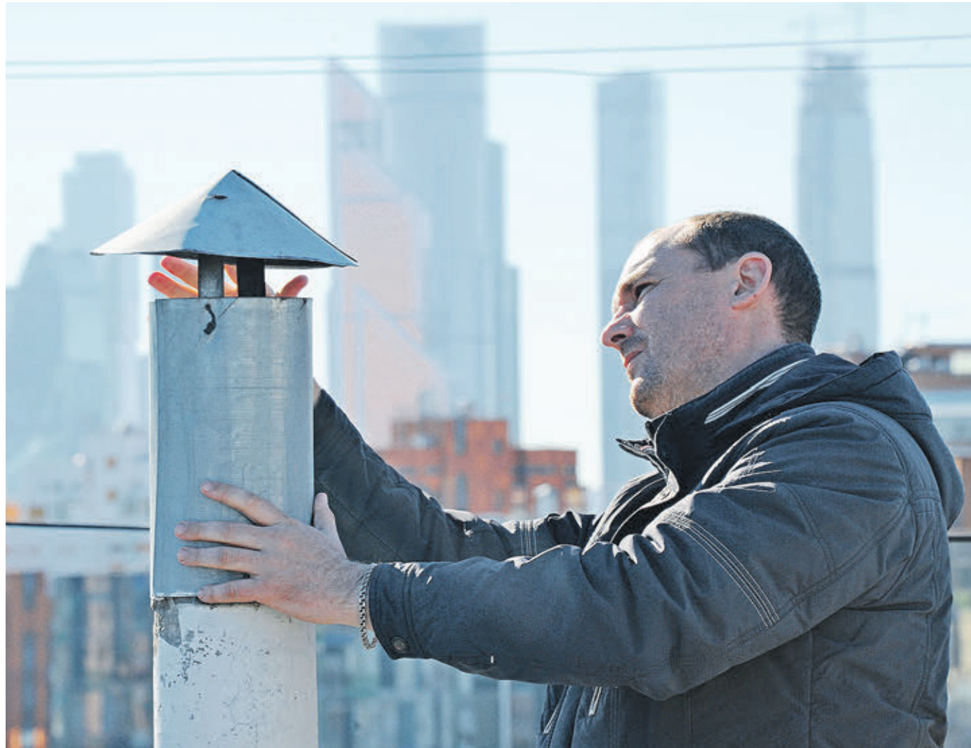
12 октября 13:12 Начальник участка компании-подрядчика Павел Кузнецов демонстрирует качество проведенных работ по капитальному ремонту на крыше многоквартирного дома
