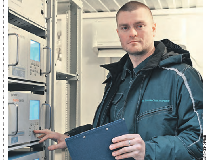
18 ноября 2021 года. Инженер ГБУ «Москоммониторинг» Евгений Казин проверяет показания автоматической станции контроля воздуха
