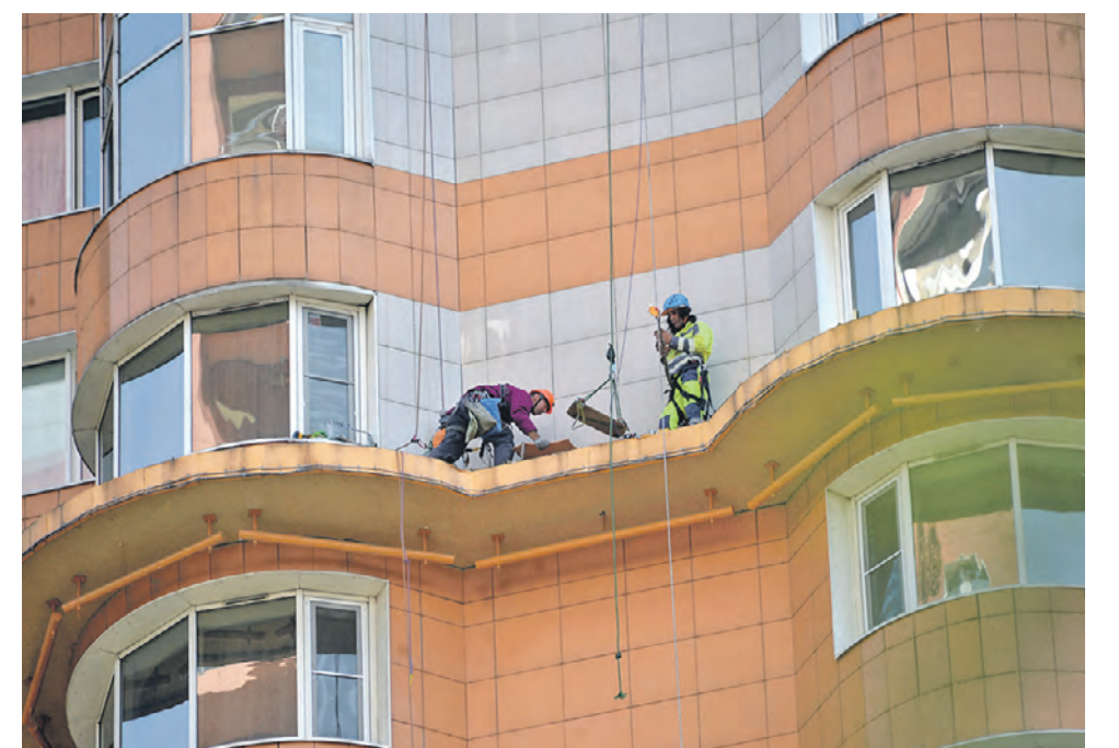
29 мая. Прошлой ночью на юго-западе Москвы дрон врезался в один из домов ЖК «Миракс Парк». Жильцы квартиры на верхнем этаже получили царапины от осколков. Пострадал фасад строения, ремонтники уже начали устранять повреждения. — Мы спали, но неожиданно жена вскопчила и разбудила меня. Тут же выбежали из дома. Взрыв был мощный. Спецслужбы приехали быстро, — поделился Валентин Волков. фото: АЛЕКСАНДР НОЧУБЕЙ
