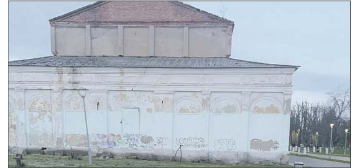
Общий вид портят заброшенные здания, находящиеся в частной собственности.
