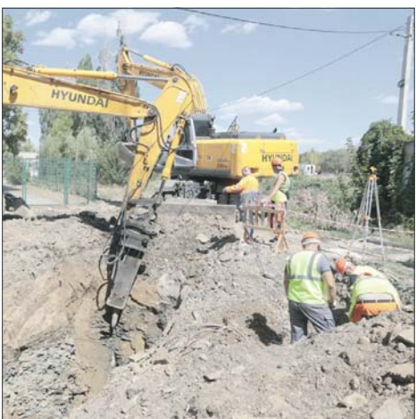
В поселке ХБК не завершили в обещанный губернатору срок работы по водопроводу и канализационном коллекторе.
