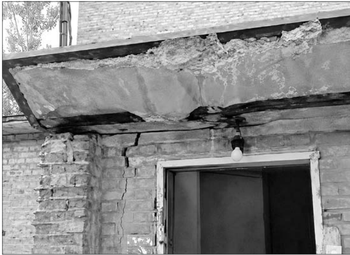
Входная группа здания и несущие конструкции разрушаются.
