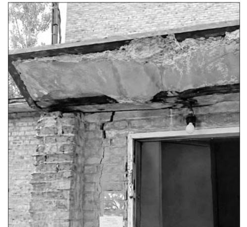
Бетонные плиты крошатся людям на головы.
