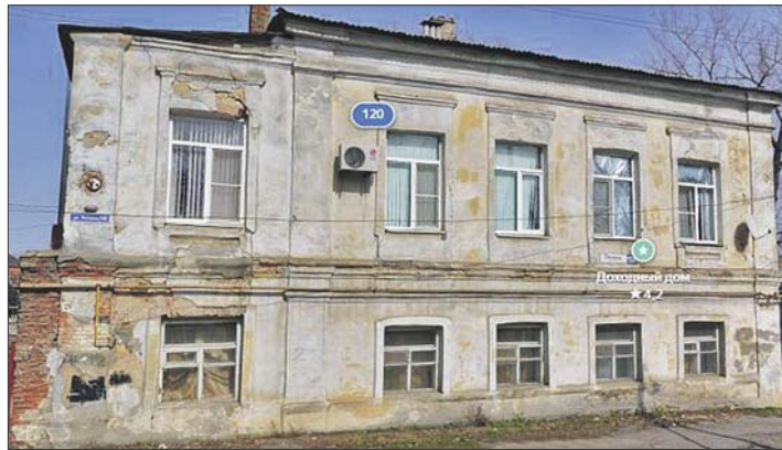
Износ дома составляет 75%.
