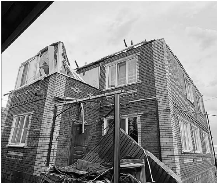
Ураган снес новую кровлю на которую копили годами.
