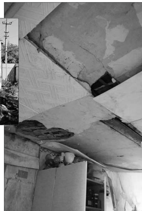
Огонь перекинулся на жилой дом с хозяйственной, в которой произошло короткое замыкание проводки.
