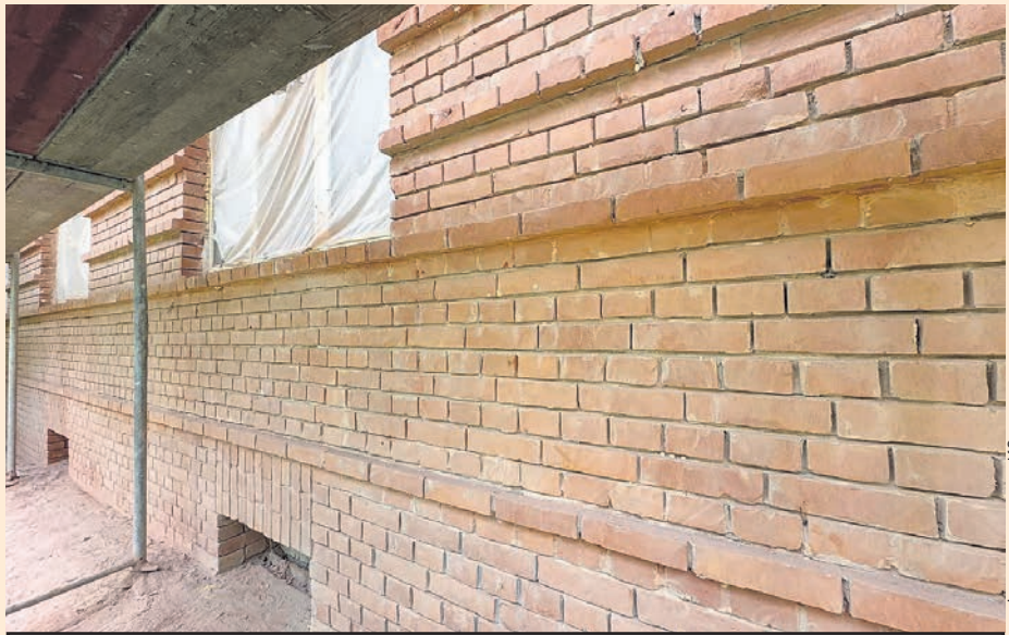
Калининградцы уверены, что «вода под давлением» не может оставлять такие глубокие царапины на кладке.
