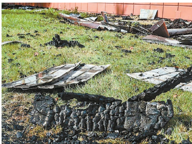
Обугленные деревянные стропила.
