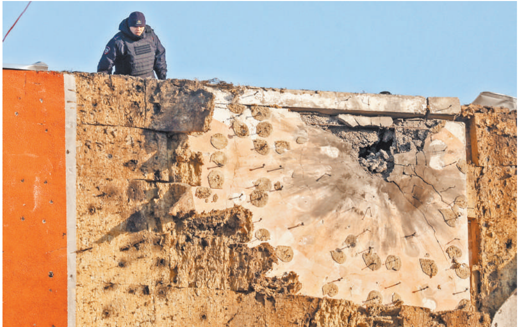
В доме на улице Домодедовской в Москве беспилотник повредил крышу, часть фасада и несколько окон.
