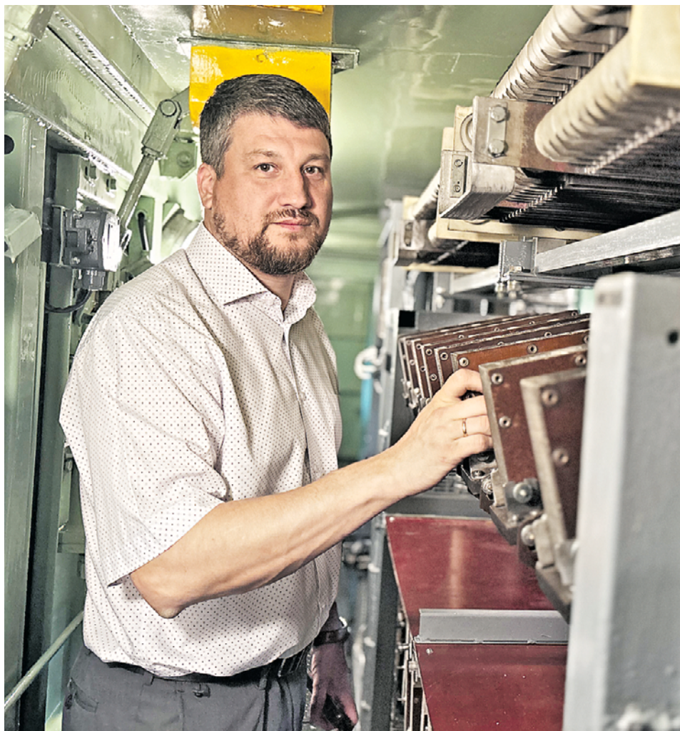
14 апреля. И. о. начальника сервисного локомотивного депо «Москва-Сортировочная» Сергей Приходько показывает устройство контакторов внутри электровоза. В каждом локомотиве 64 таких детали. ФОТО: ВАСИЛИСА ЧЕРНЯВСКАЯ
