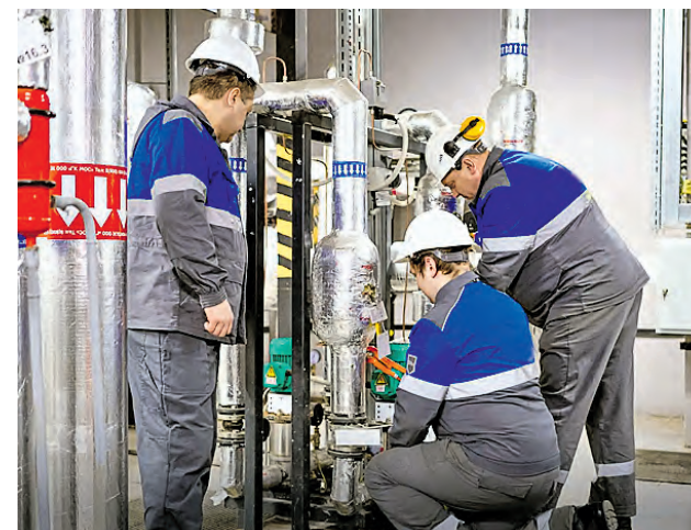
Тепловой пункт ПАО «МОЭК» готов в отопительный период
